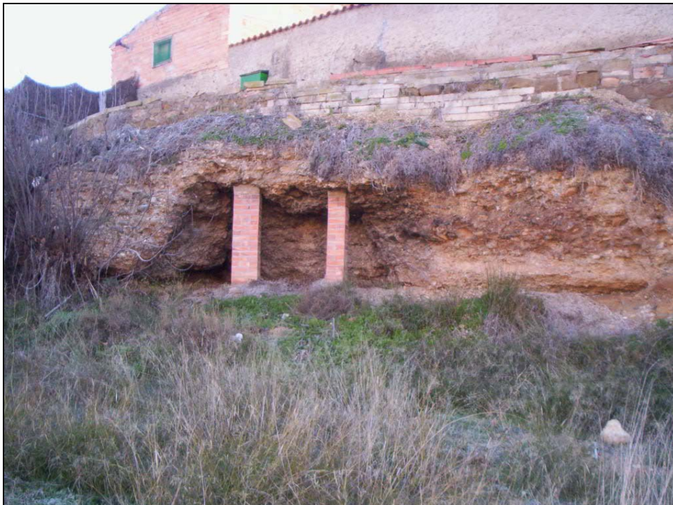
Fotografia 7. Exemple d'erosió diferencial que podria provocar la caiguda de blocs per volcada.
