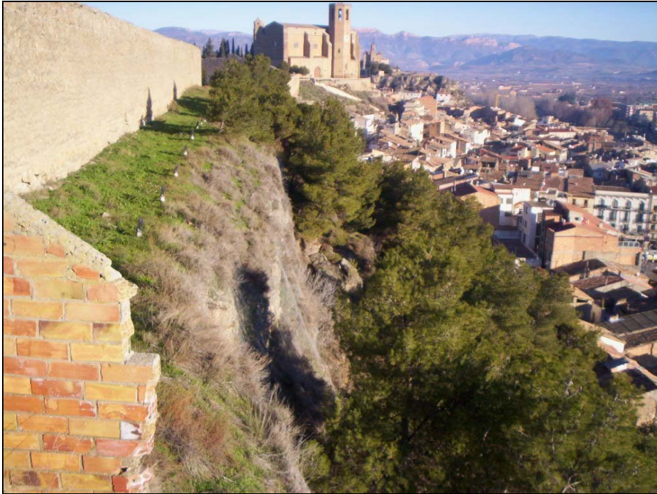
Fotografia C. Vista frontal de la muralla, amb el talús o vessant on es recomana realitzar-hi un estudi detallat d'estabilitat, es pot observar alhora la seva situació respecte les edificacions.
