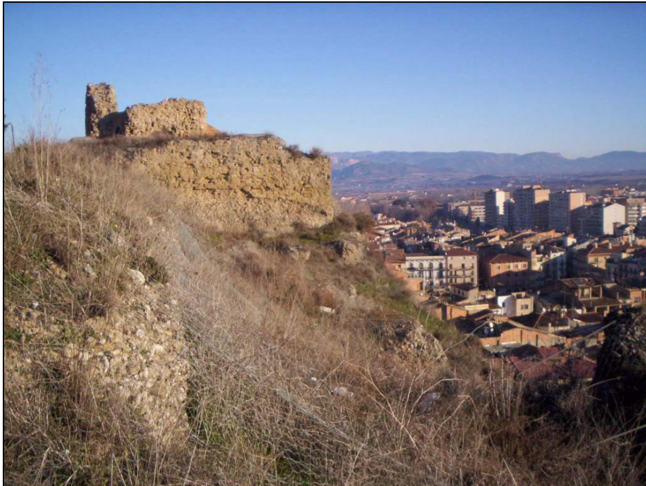
Fotografia 10. Exemple d'una de les malles de protecció col·locada al talús. Aquesta es troba separada i amb un mal manteniment, ja que pel seu correcte funcionament hauria d'estar enganxada al talús.
