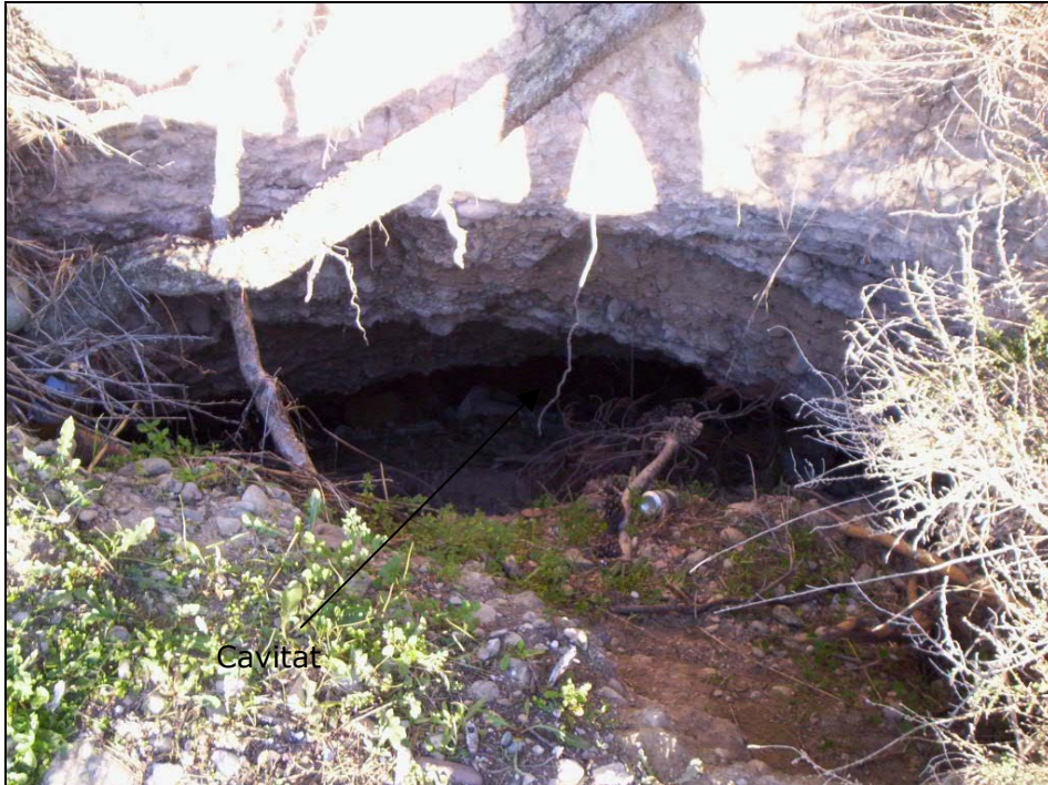
Fotografia 6. Exemple d'una cavitat detectada propera a la zona on es projecta la restauració de la muralla.
