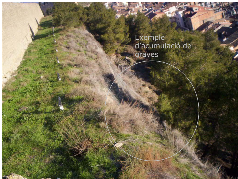
Fotografia 5. Exemple d'una de les zones amb acumulació de graves, per pèrdua de cohesió adquirida de la carbonatació inicial.
